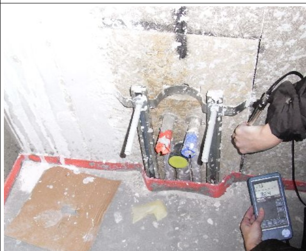
Bagno: Perdita allacciamento idraulico: 3,24 m/s
